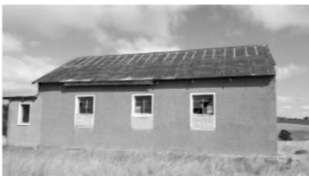
Die alte Kirche - das Dach ist undicht, Fenster eingeworfen.
